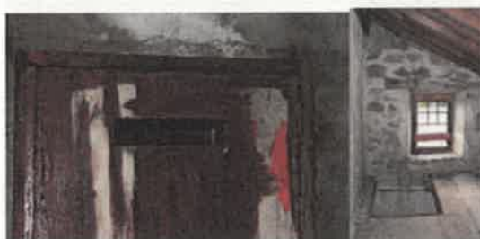
Exemple de simple accès dédié aux chiroptères et ne permettant pas le passage de pigeons au niveau d'ouvertures déjà présentes
